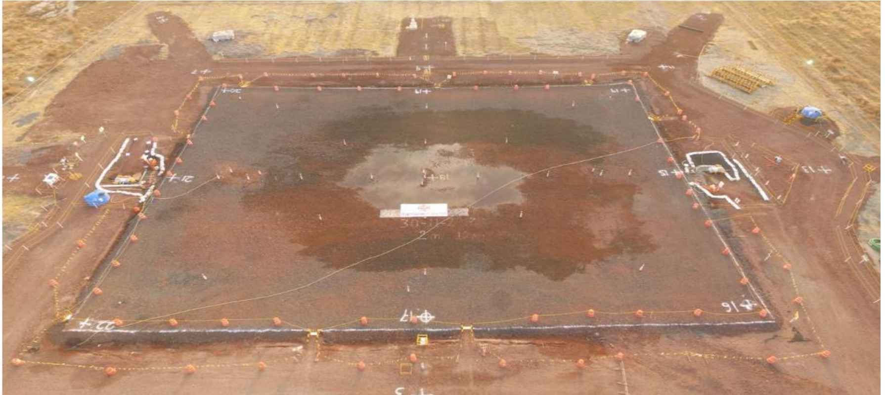
Figura A.6. "Vista aérea del panel de prueba de consolidación acelerada con vacío con membrana - Menard Vacuum - en donde se observa el espejo del nivel natural del agua del terreno que está por arriba de la última capa del relleno de compensación: Al momento de la foto, el terraplén de 2.0 m de altura total tenía ya un asentamiento producido de 2.94 m y el nivel natural del agua del terreno se encuentra a 0.80 m bajo el nivel original de terreno (14 cm de tirante de agua sobre el panel)"
