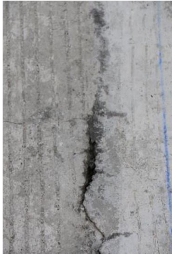
Figura 49. Grietas Plataforma B
