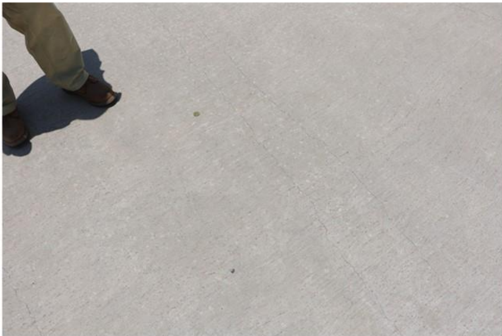
Fig. 4.1.9.67. Visita técnica del 22 de junio de 2018 (evolución de grietas)
