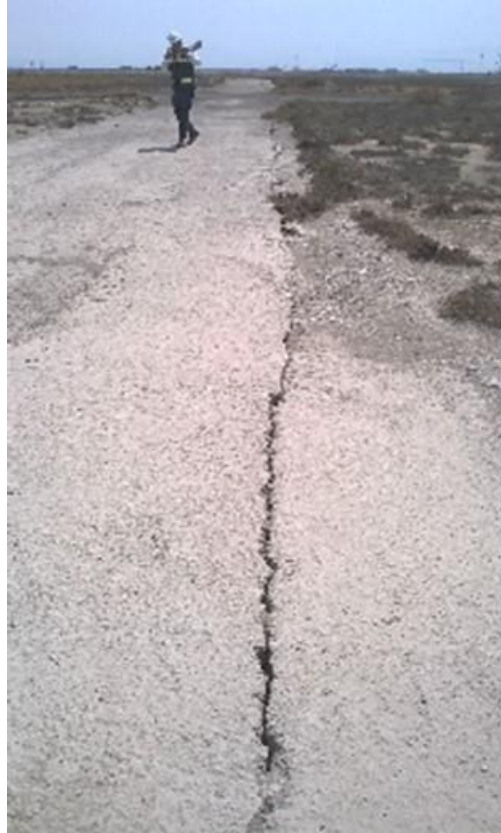
Figura 4.9.2.14. Grieta longitudinal en la plataforma
