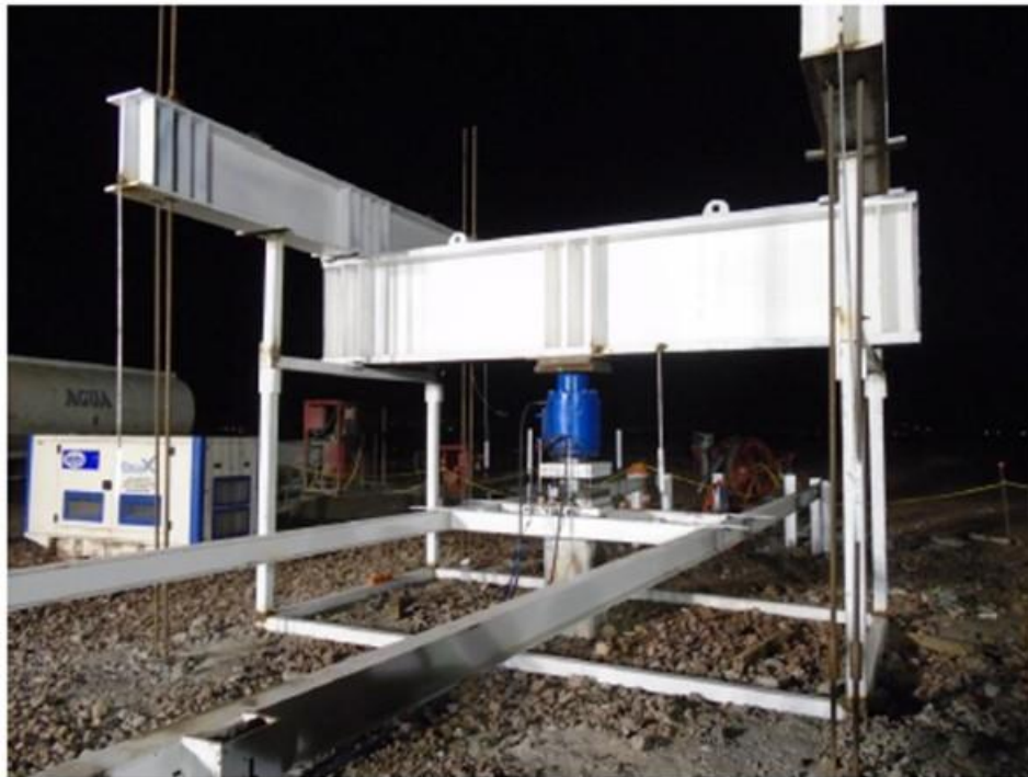
Figura C1. Vista general del sistema de reacción
