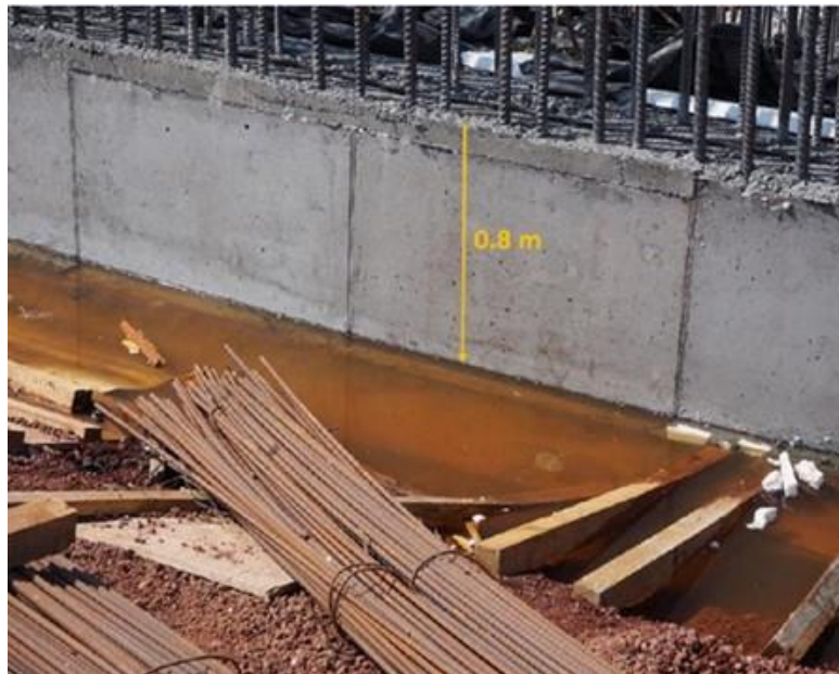
Figura 1. Espejo de agua a 80 cm del borde superior de la losa.
