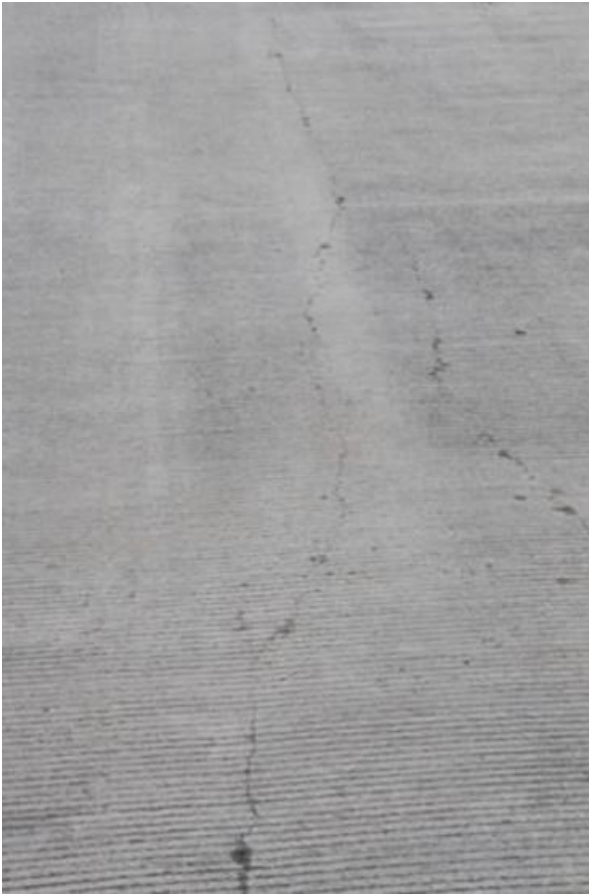
Figura 48. Grietas Plataforma B
