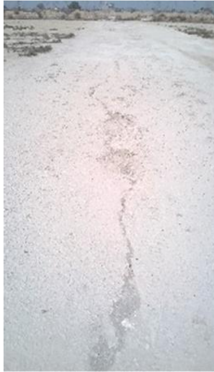
Figura 4.9.2.12. Grieta longitudinal en la plataforma
