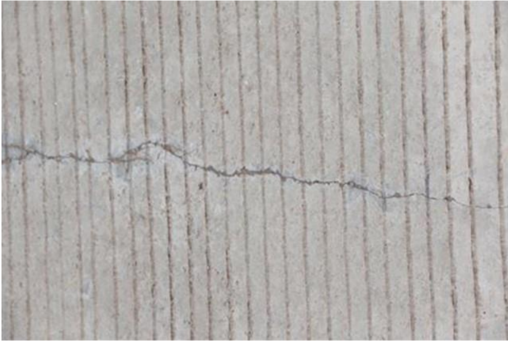
Figura 54. Grietas Plataforma B
