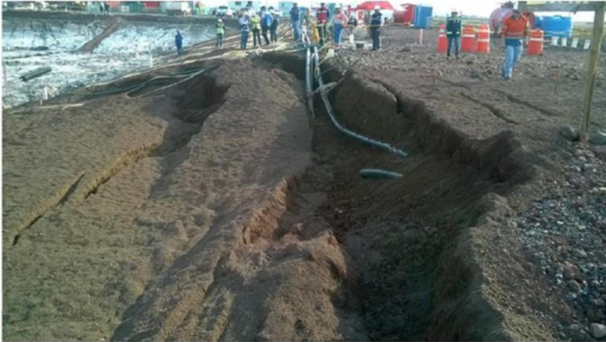
Figura 2. Falla en el talud poniente, cerca de la esquina del talud norte de la excavación de prueba (NT GEO-80, 2016).
