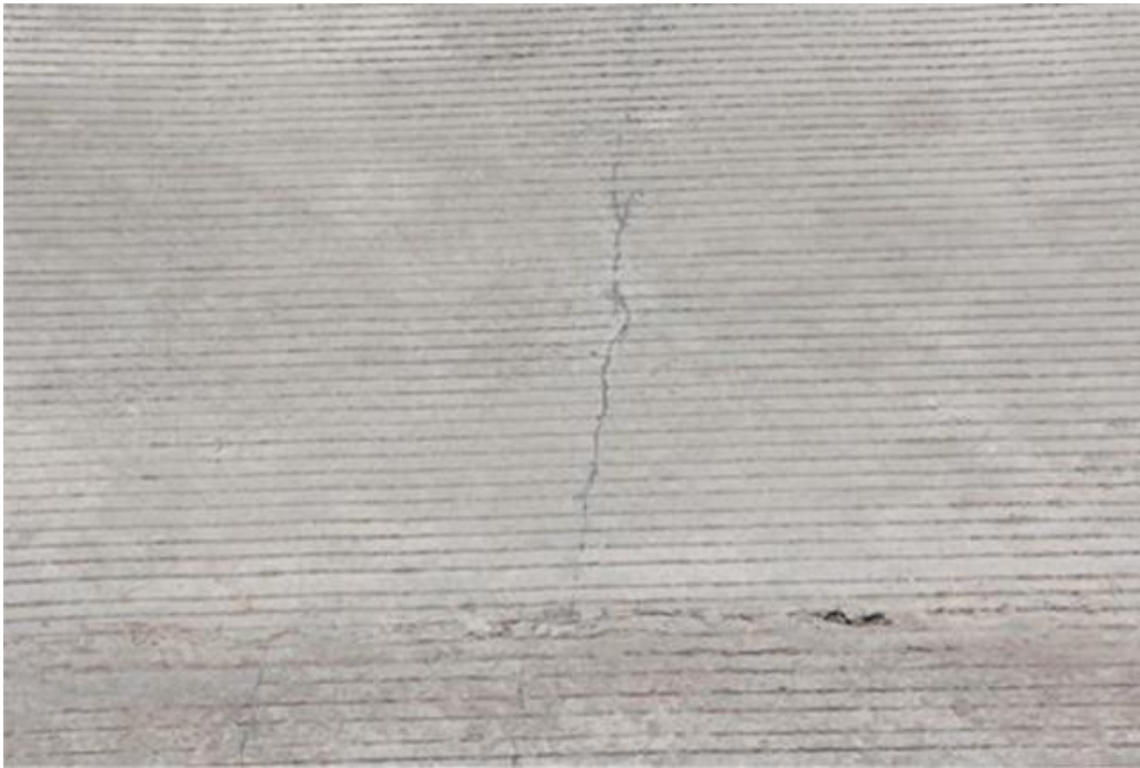
Figura 55. Grietas Plataforma B
