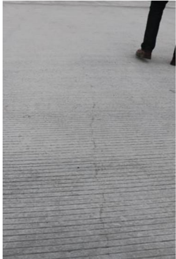
Figura 45. Grietas Plataforma B
