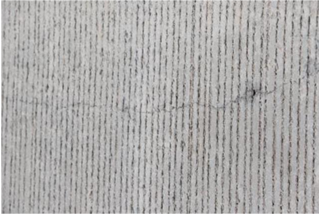
Figura 56. Grietas Plataforma B
