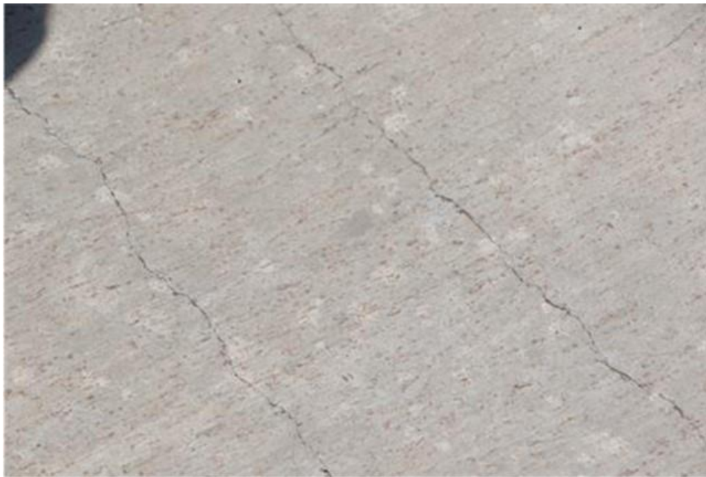
Figura 51. Grietas Plataforma A
