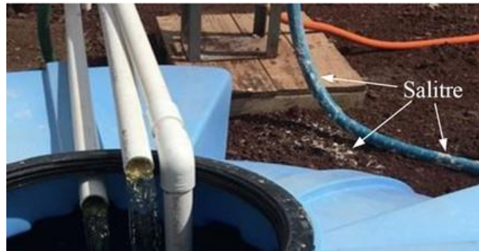
Figura 10. Formación de salitre en las tuberías del agua subterránea extraída
