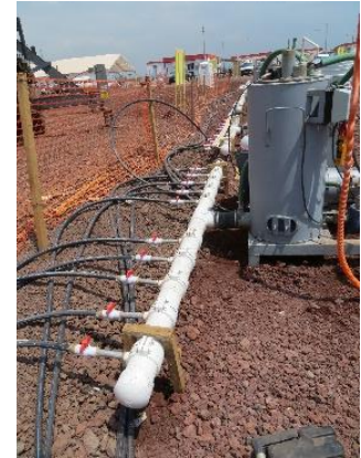
(c) Conexión a las bombas
