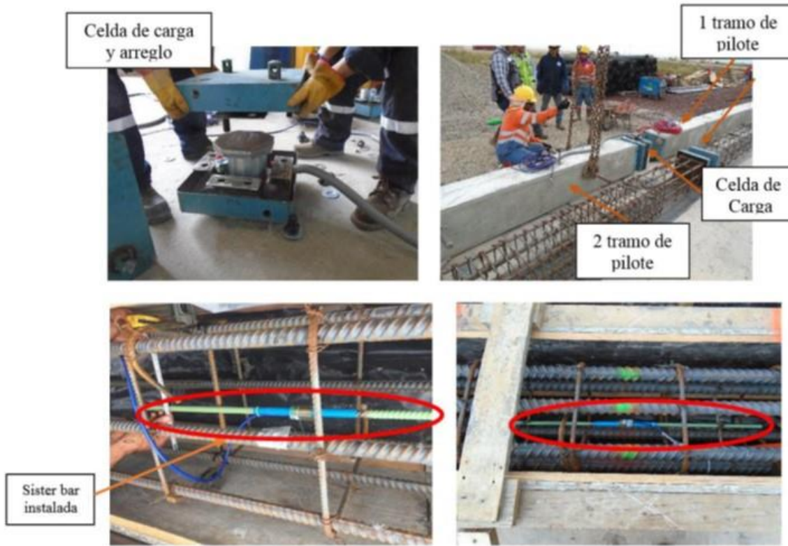
Fig. 4.2.2.1. Instrumentación de pilotes
