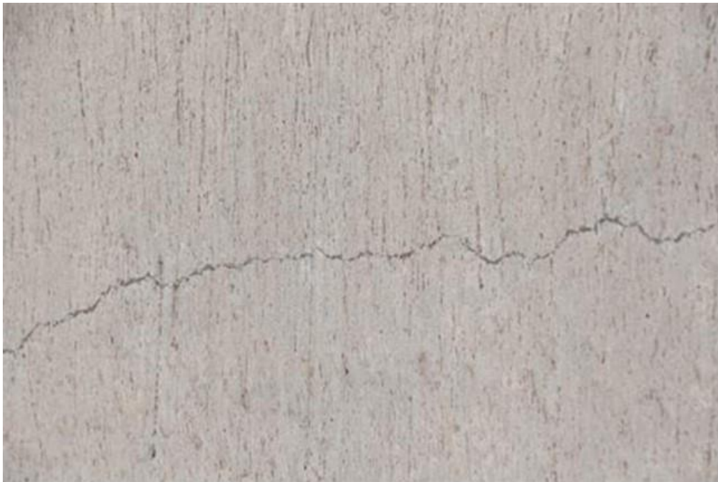
Figura 52. Grietas Plataforma A
