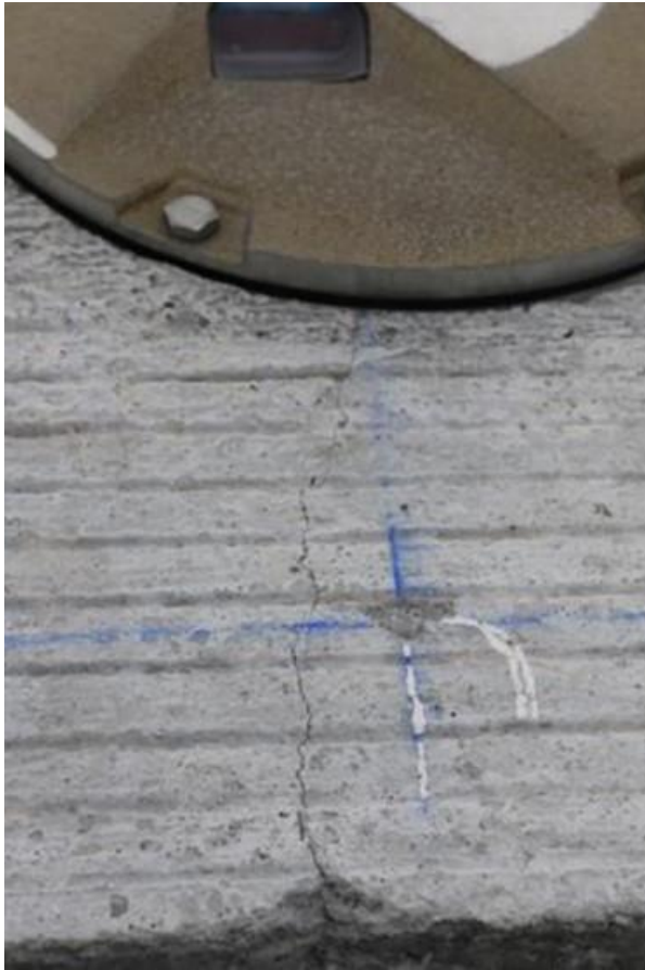
Figura 46. Grietas Plataforma B
