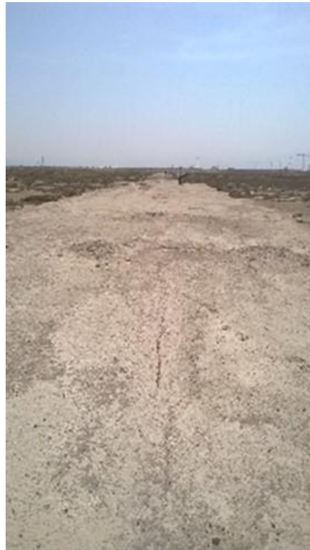
Figura 4.9.2.11. Grieta longitudinal en la plataforma
