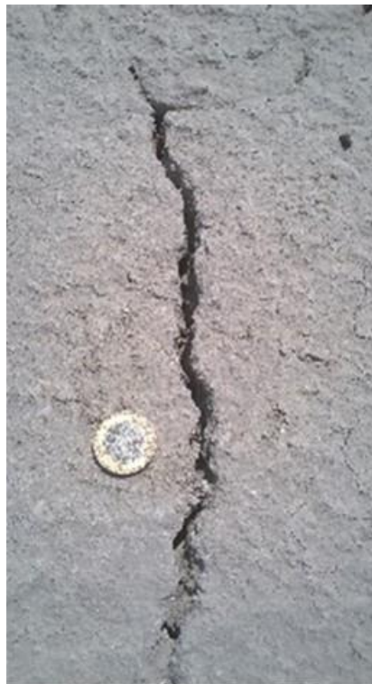
Figura 4.9.2.13. Grieta longitudinal en la plataforma
