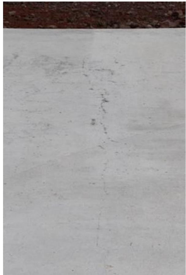
Figura 42. Grietas Plataforma A
