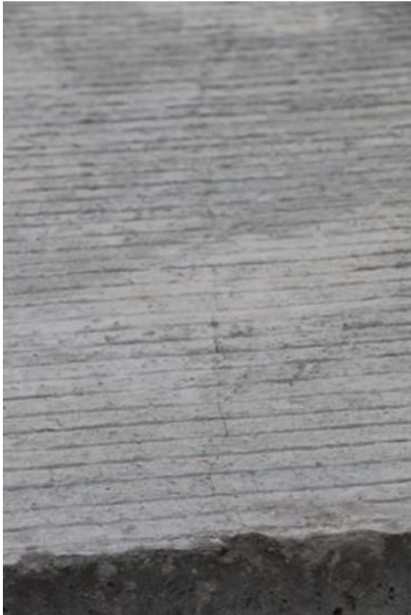
Figura 44. Grietas Plataforma B
