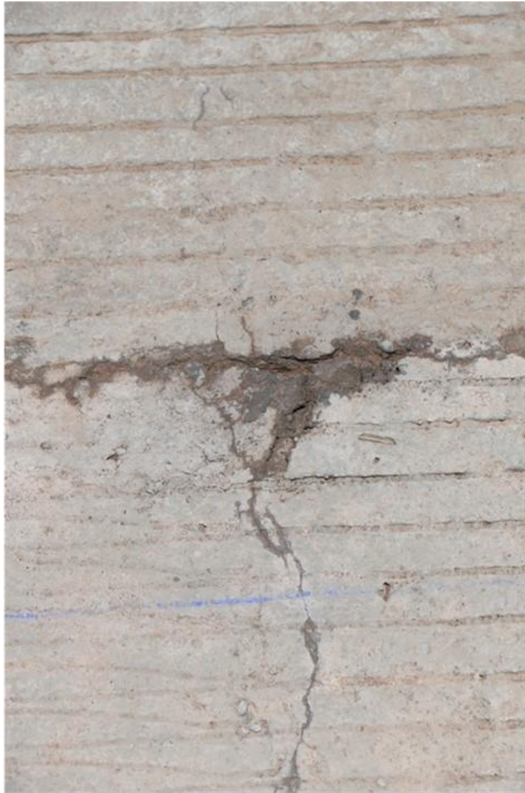
Fig. 4.1.10.75. Visita técnica del 22 de junio de 2018 (evolución de grietas)
