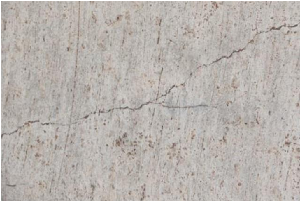
Figura 53. Grietas Plataforma A
