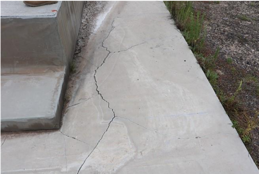
Fig. 4.1.10.77. Visita técnica del 22 de junio de 2018 (aparición de grietas en la plantilla en extremo sur-oriente)
