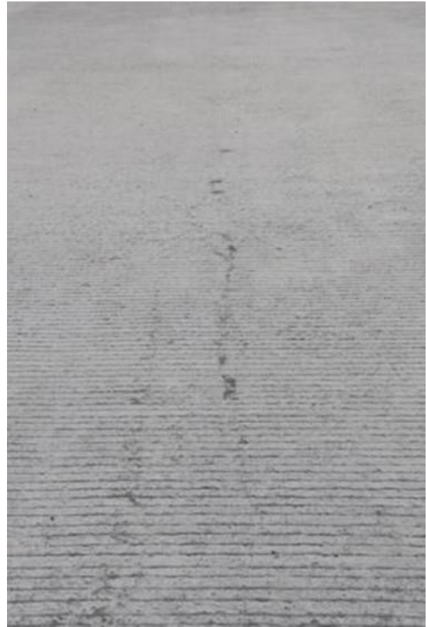
Figura 47. Grietas Plataforma B
