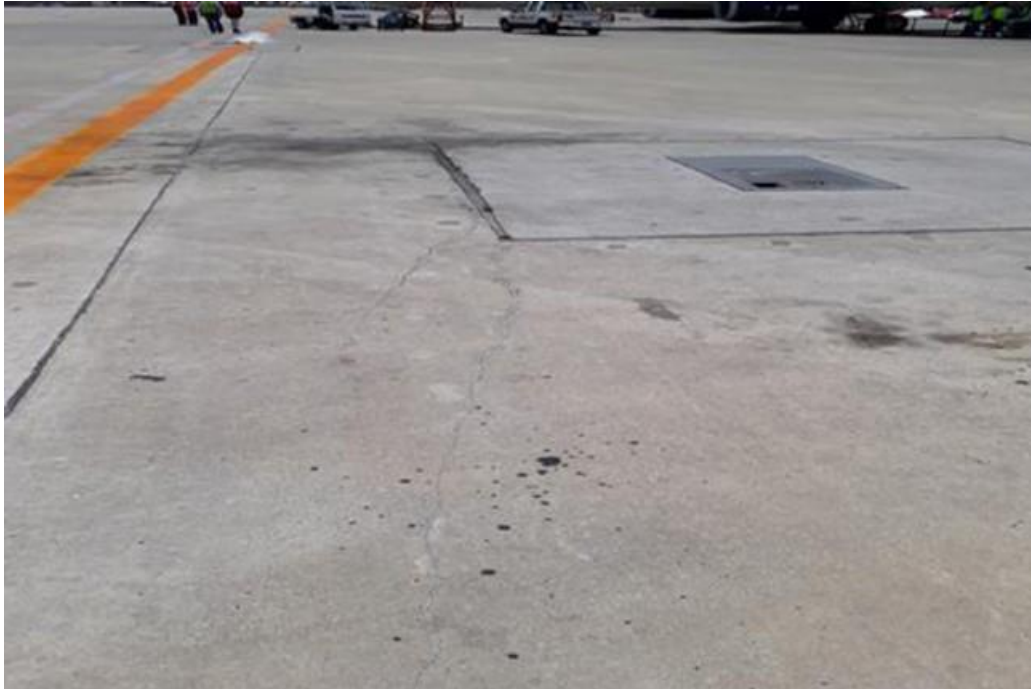
Figura 68. Agrietamientos asociados a la presencia de estructuras
