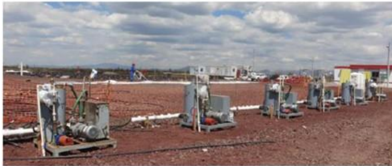
(a) Bombas para aplicación de presión de vacío
