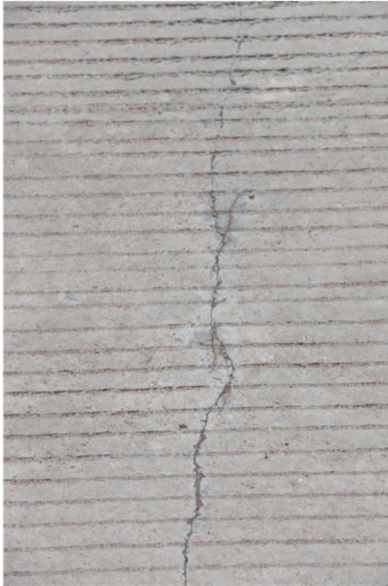
Fig. 4.1.10.74. Visita técnica del 22 de junio de 2018 (evolución de grietas)
