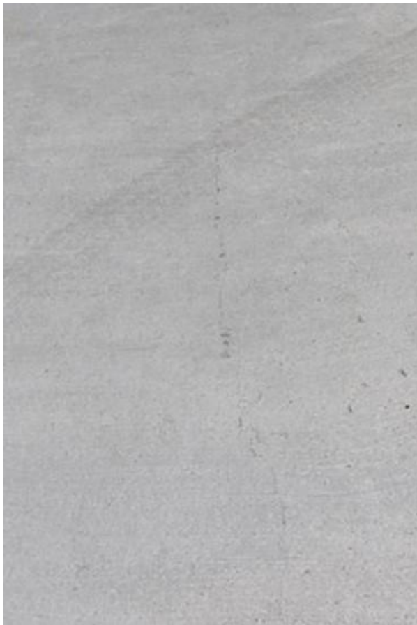
Figura 41. Grietas Plataforma A
