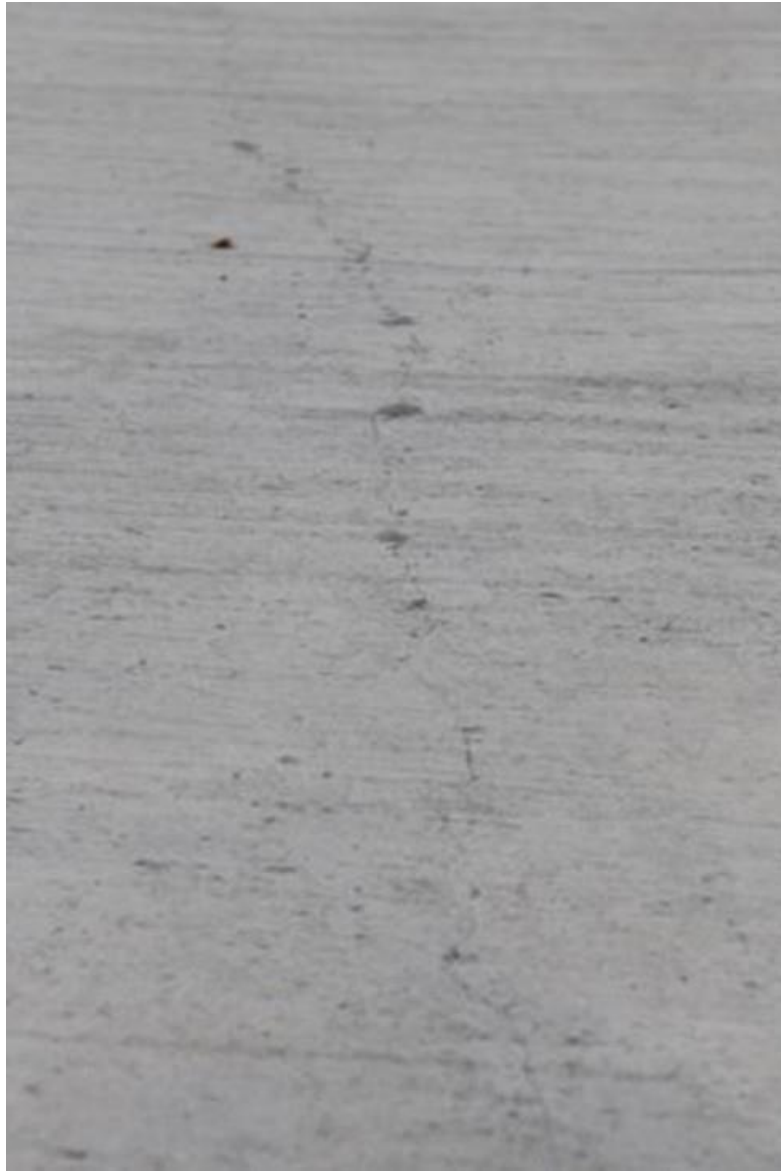
Figura 43. Grietas Plataforma A
