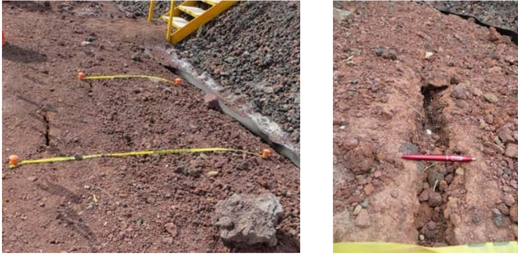
Fig. 4.1.3.20 Grietas ocasionadas por la presión de vacío en el contorno de la plataforma de prueba de precarga con vacío con membrana y PVDs
