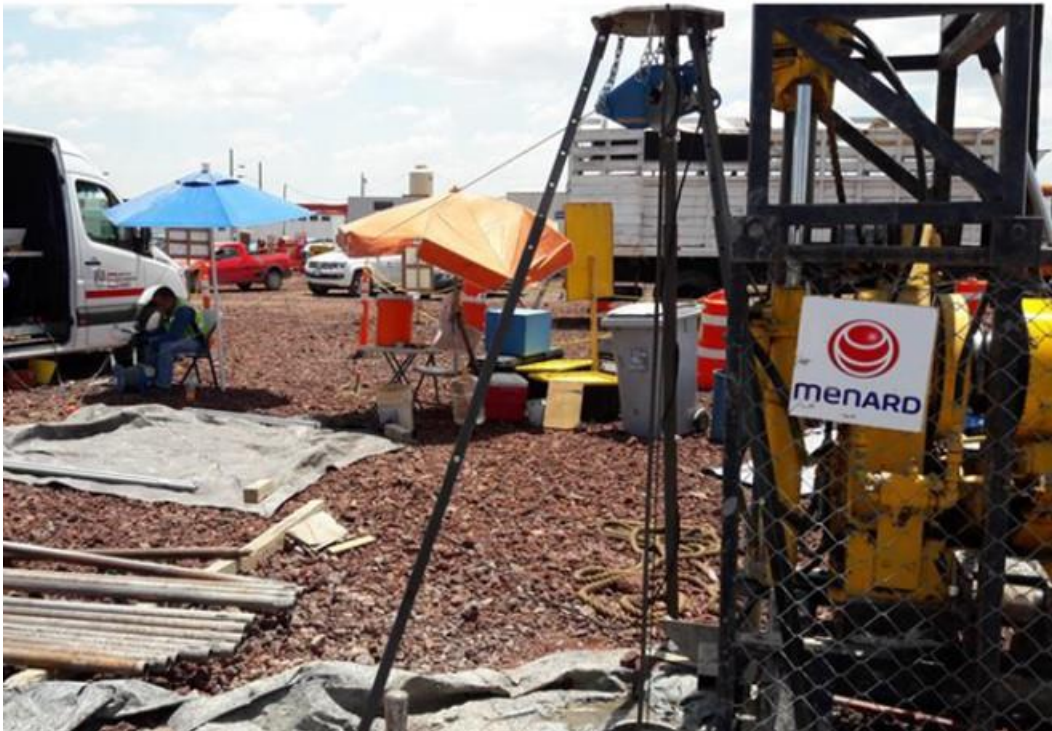
Figura 2. Ensaye de sonda suspendida en el tramo de vacío con membrana hermética.
