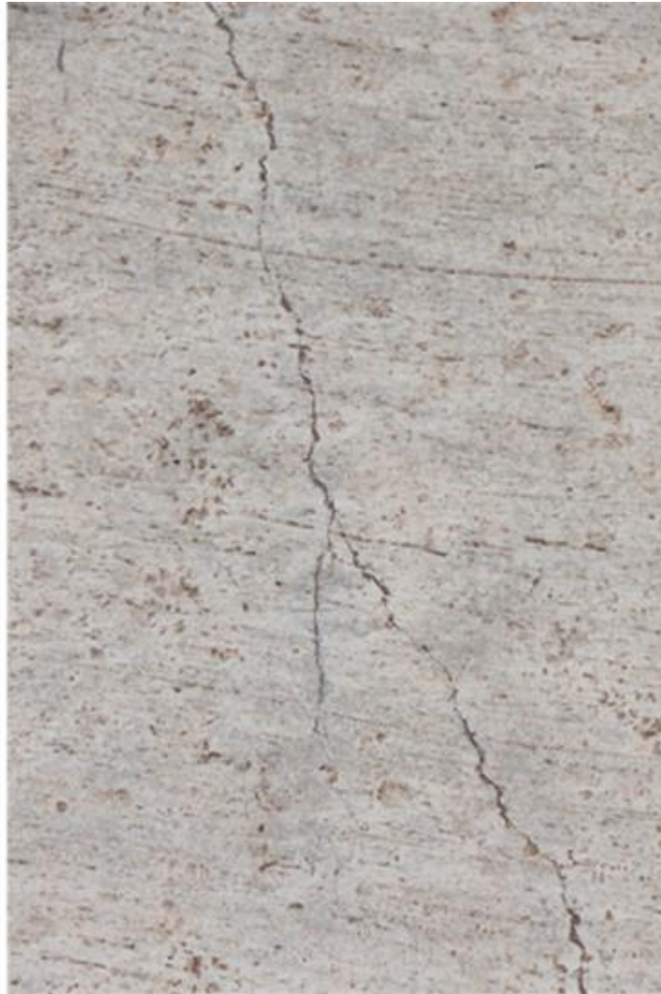
Fig. 4.1.9.68. Visita técnica del 22 de junio de 2018 (evolución de grietas)
