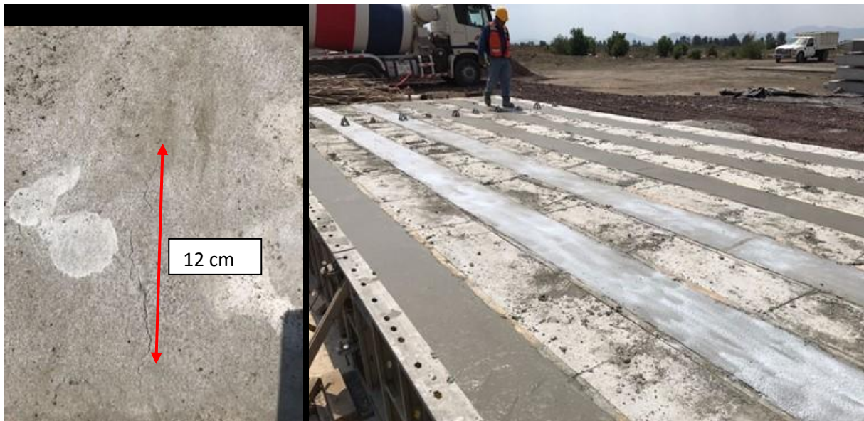
Fig. 4.9.2.2.1. Agrietamiento transversal en pilotes y sus camas de colado
