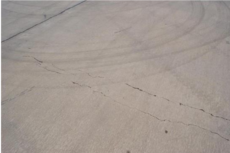
Figura 60. Agrietamiento de losas
