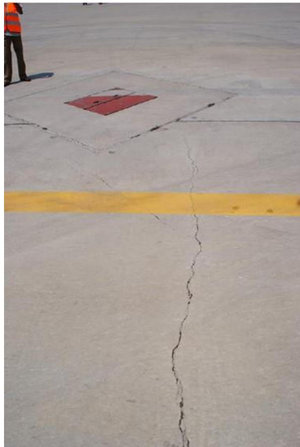
Figura 61. Agrietamientos asociados a la presencia de estructuras
