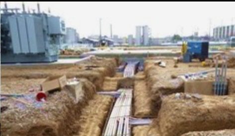
Red de Distribución Eléctrica
